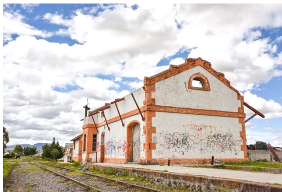
Gare de Calpulalpan, placée au nord-ouest de l'État de Tlaxcala. Il s'agit d'une des gares qui se trouve dans un état de dégradation plus profond. Il est possible de remarquer le manque de certains éléments comme le toit, et que ses murs ont été vandalisés. Auteur photo : Nazim Avendaño Ramos.
